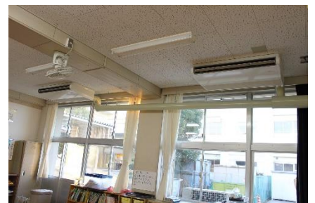
2月：エアコンが設置された教室の様子
